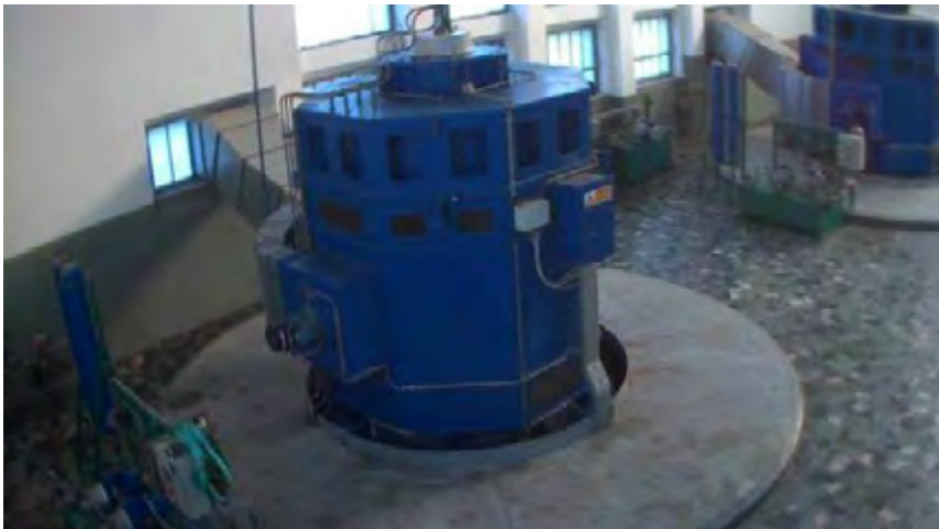
Web camera esposta che mostra un'infrastruttura idrica
